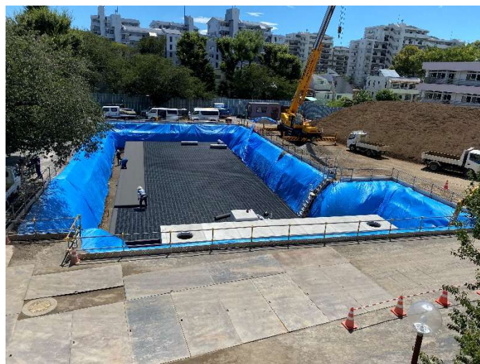
雨水貯留浸透施設(桜野小学校)
