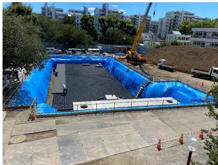
雨水貯留浸透施設(桜野小学校)
