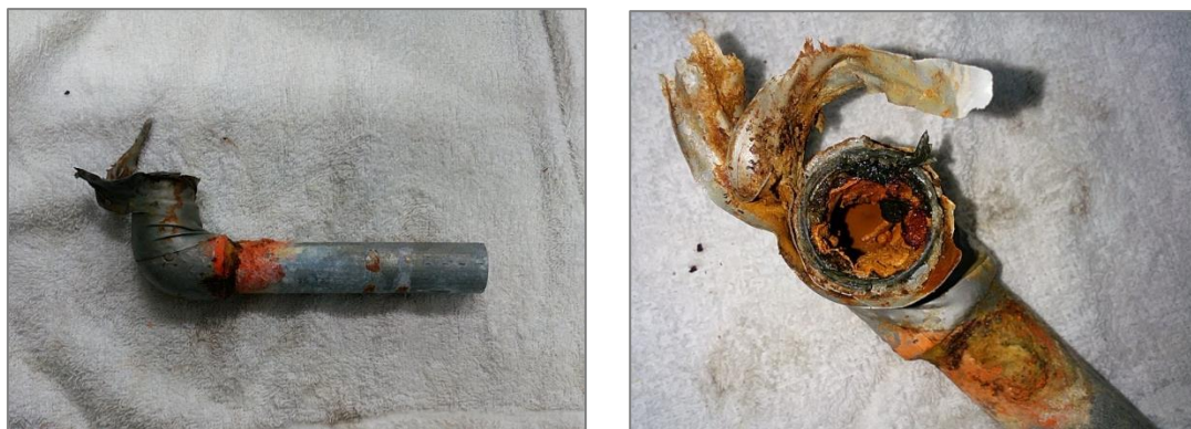
漏水した給水管の状況
