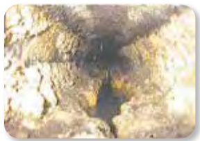
油などが詰まった下水道管内
