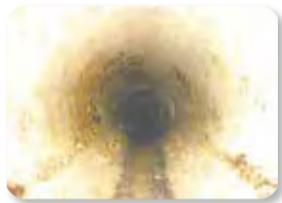
通常時の下水道管内
