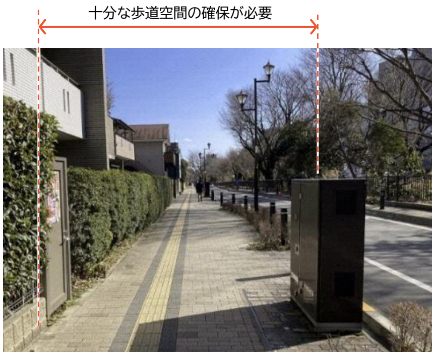
図3-10 歩道上に設置される地上機器（御殿山通り）
