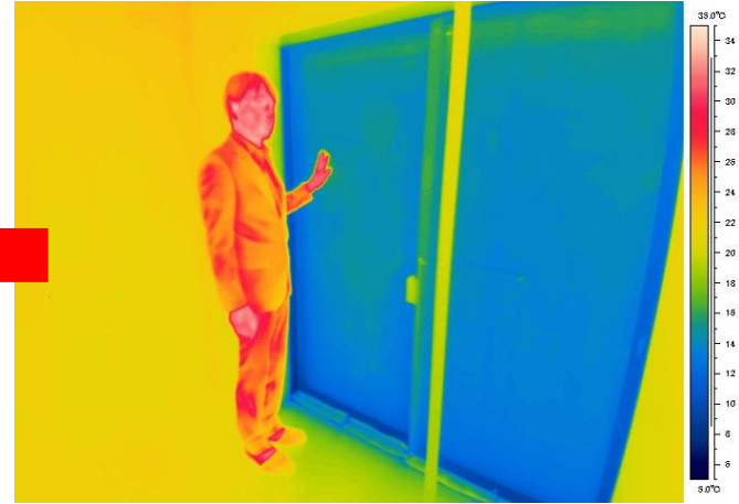
単板ガラス&アルミサッシの窓付近のサーモ画像
