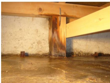
床下漏水による基礎の腐食
