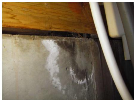
基礎内側の漏水跡
