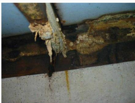
床下漏水による腐食・カビ
