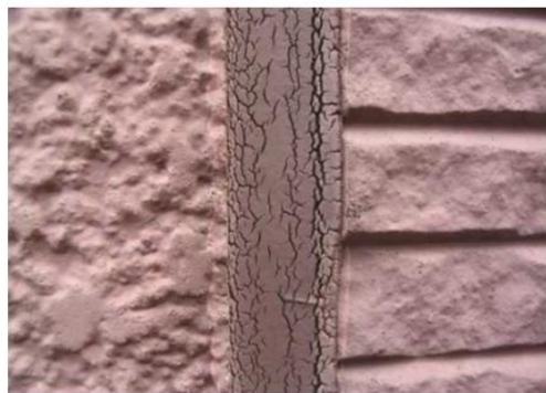
外壁サイディングシールの劣化
