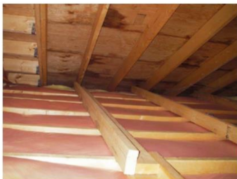
屋根下、天井上の雨漏り跡
