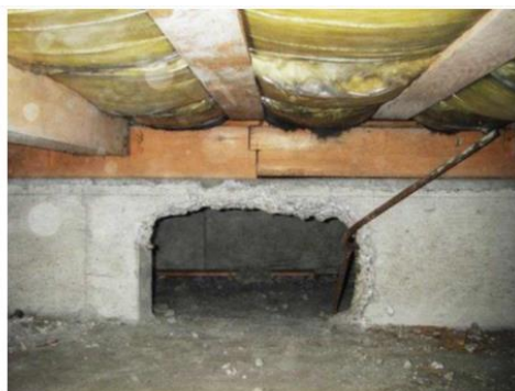
床下断熱材の剥がれ
