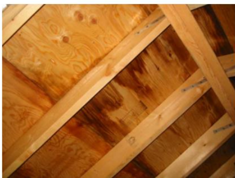
屋根下の雨漏り跡
