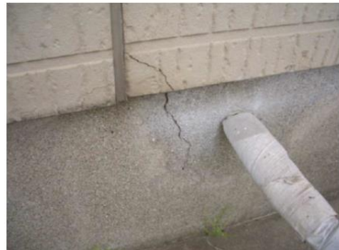
配管部のひび割れ
