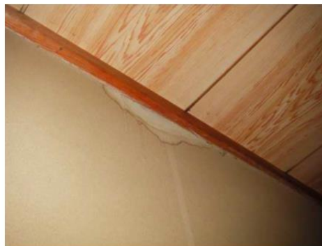
天井縁の雨漏り跡
