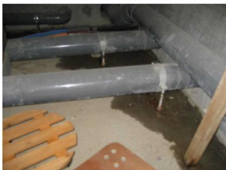
床下排水管からの漏水
