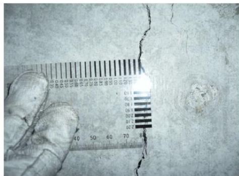
0.5 mm以上のひび割れは要注意
