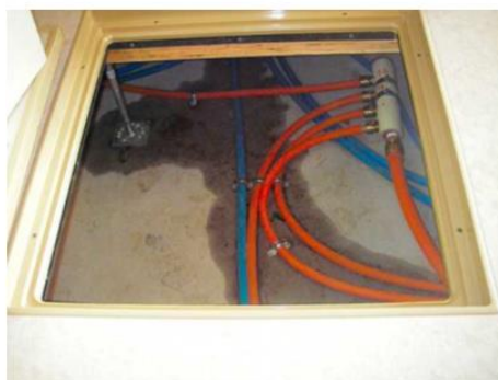
床上下水管の水漏れ
