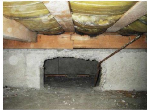
床下断熱材の剥がれ
