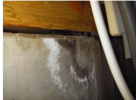
基礎内側の漏水跡
