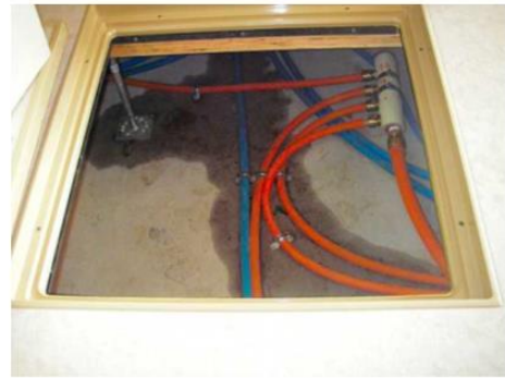
床下上水管の水漏れ
