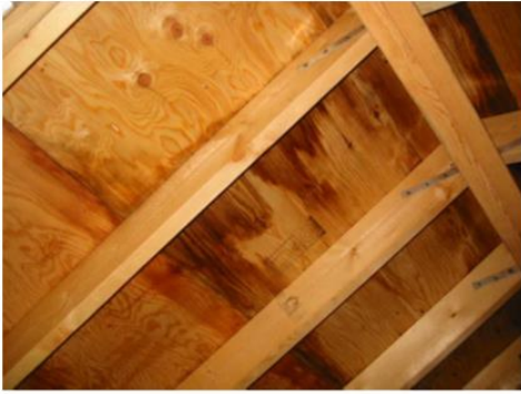
屋根下の雨漏り跡
