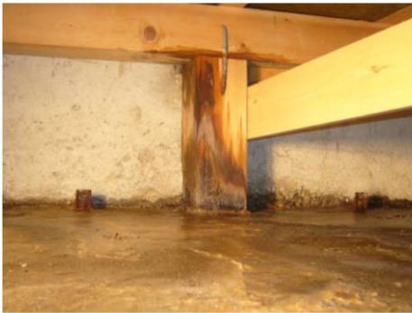
床下漏水による基礎の腐食
