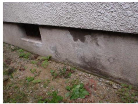
基礎に表れた漏水
