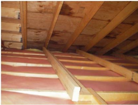
屋根下、天井上の雨漏り跡
