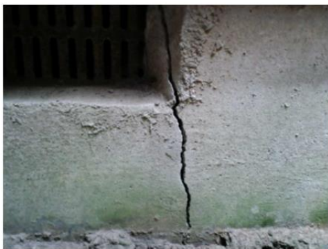
換気口角のひび割れ
