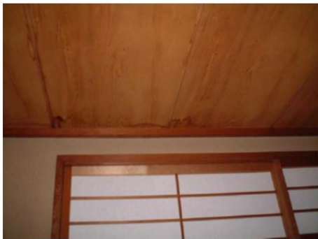
窓際天井の雨漏り跡
