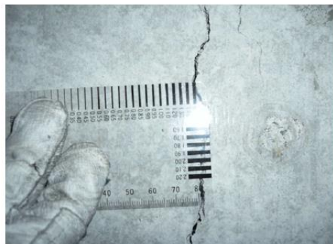
0.5 mm以上のひび割れは要注意
