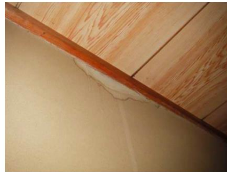
天井縁の雨漏り跡
