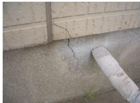
配管部のひび割れ
