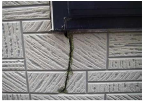
外壁サイディングのひび割れ・サッシ下
