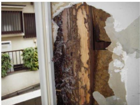
サッシ回りの壁への雨水侵入と腐食
