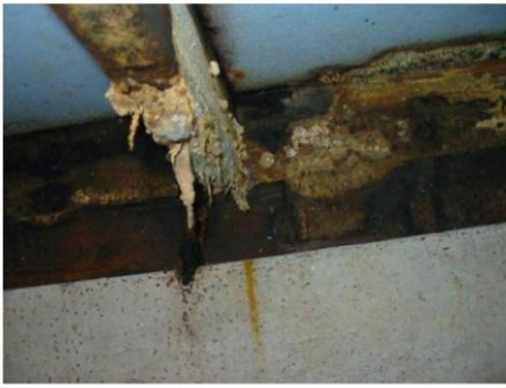
床下漏水による腐食・カビ
