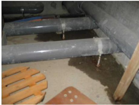
床下排水管からの漏水
