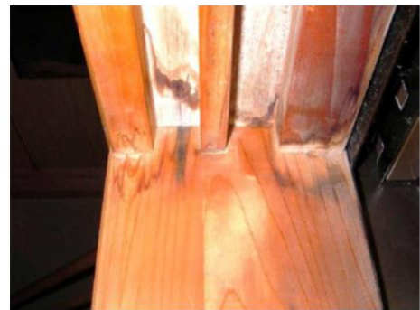
サッシ上側の雨水浸入跡
