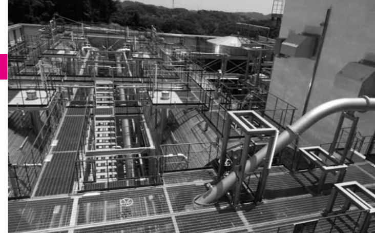
首都圏で初めて建設されたバイオガス化施設
