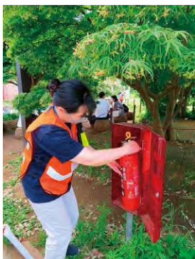
地域設置消火器の点検
