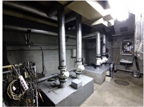
【機械室内旧式機械設備】
