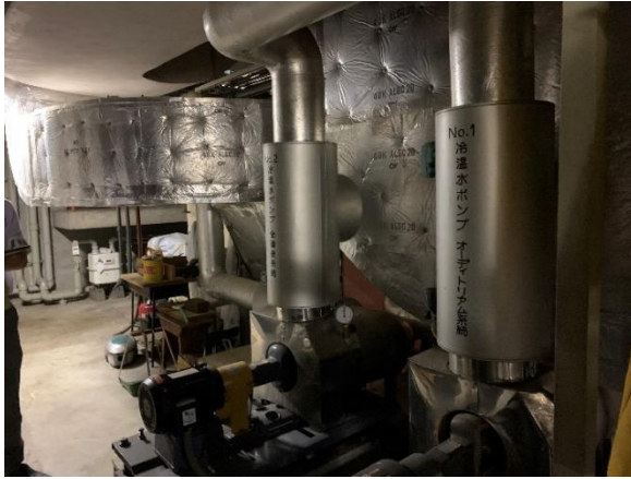
【機械室内旧式機械設備】
