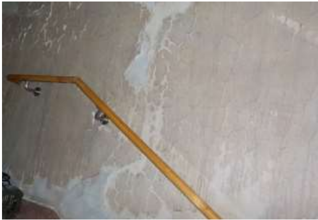
会議室棟 4階 階段(南) ひび割れ 125
