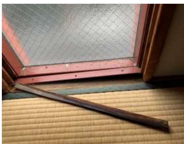
▲枠 浮き（劣化状況）
