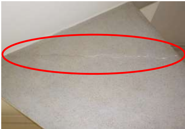
会議室棟 2階階段（南）（ひび割れ） 88
