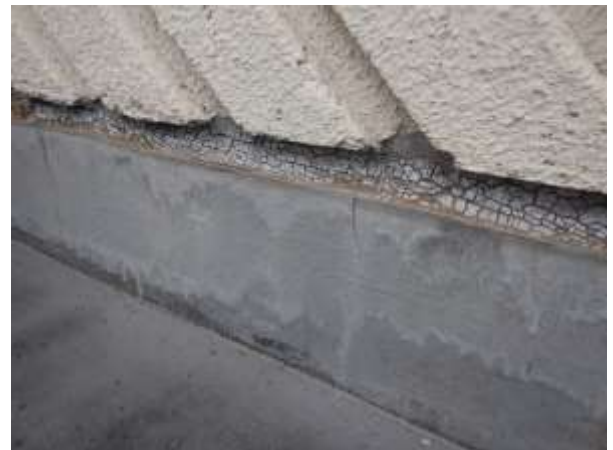
▲シーリングの劣化（劣化状況）
