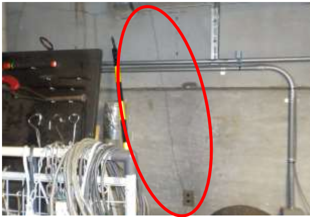
会議室棟 B1階（機械室） 8
