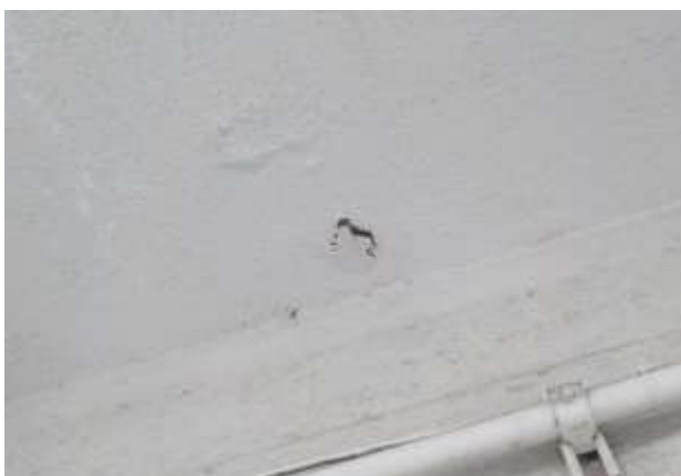
会議室棟 3階バルコニー 底下（鉄筋露出） 109
