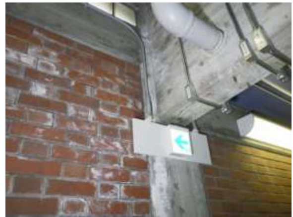
ホール棟 B1階 舞台袖 天井漏水 41
