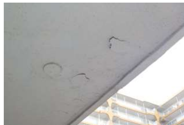
会議室棟 2階バルコニー（剥離） 84
