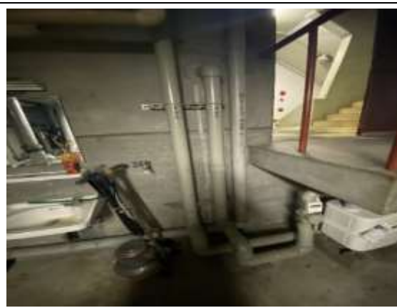
ガスメーター廻り配管
