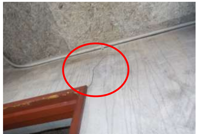
会議室棟 5階機械室 開口周りのひび割れ
