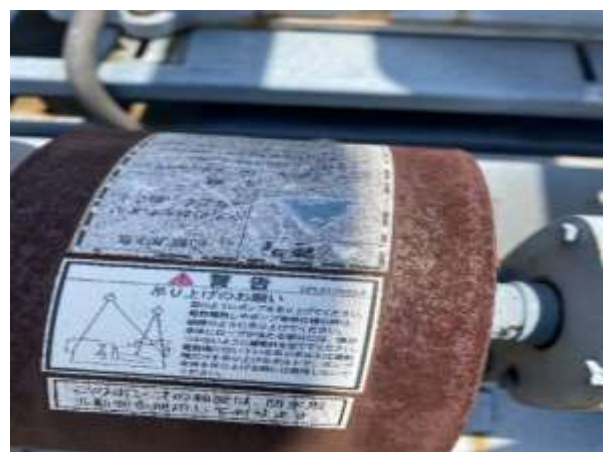
屋上冷却ポンプ
