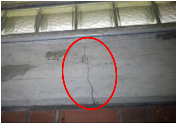
ホール棟 B1階 客用通路(南) (ひび割れ) 32
