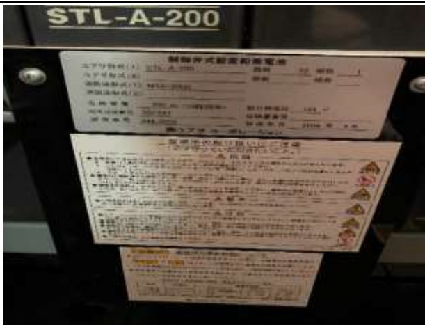
非常発電設備 (設置 2004 年 6 月)
