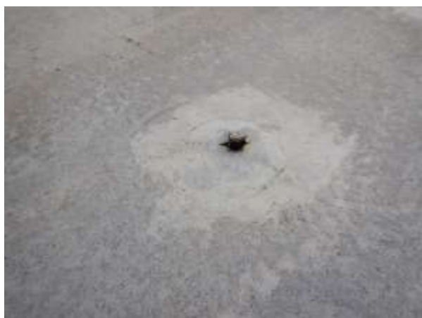
▲平場部 アンカー突き上げによる破断
