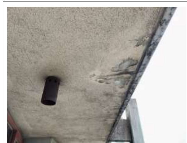
▲塗装の剥がれ（劣化状況）
