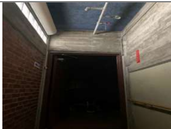
地下消火配管
