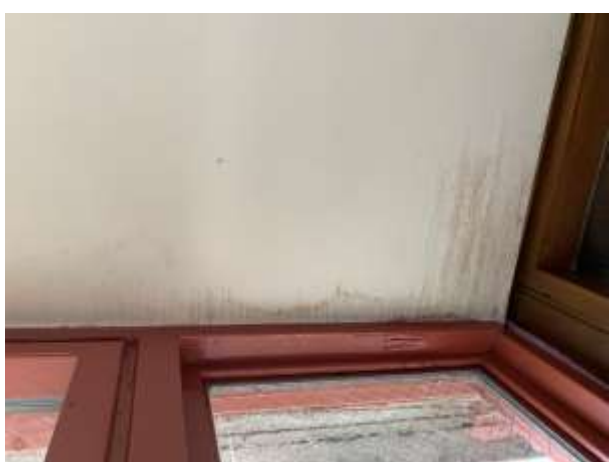
▲建具上部 漏水（劣化状況）
