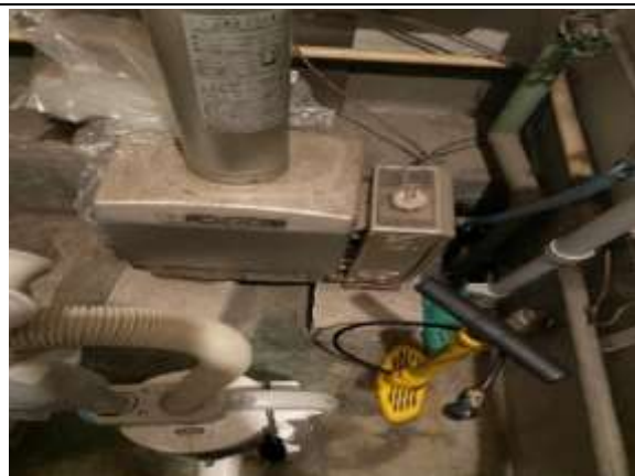
地下ボイラー
