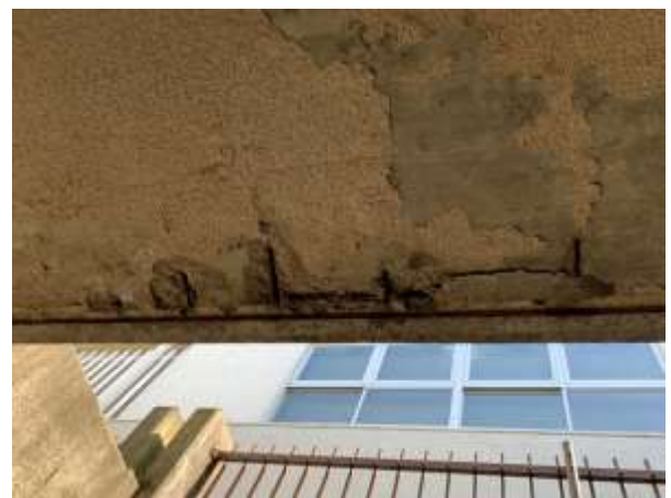
▲塗装・躯体の剥離（劣化状況）
