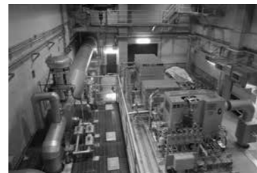
王禅寺処理センターのごみ発電設備(蒸気タービン発電)。新クリーンセンターにも設置される。地球温暖化対策にも寄与し、防災にも役立つ。
