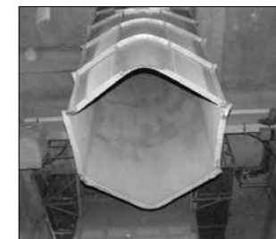
爆発事故で大破し垂んだ設備。復旧には莫大な費用・時間・労力がかかります。周辺住民も不安です。
