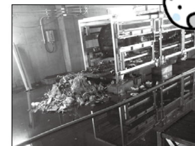
平成30年2月22日の粗破砕物 搬送コンベヤ上の燃え殻
