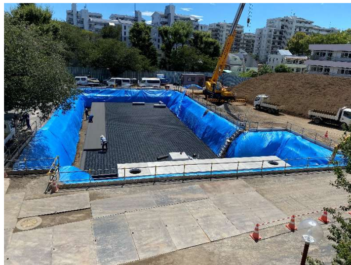
雨水貯留浸透施設(桜野小学校)
