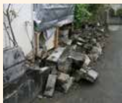
地震で崩れたブロック塀
