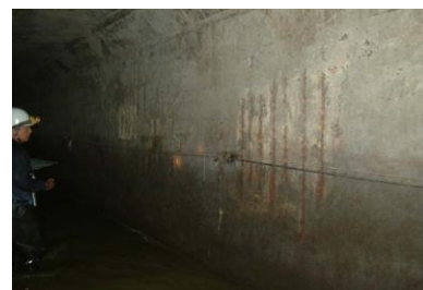
鉄筋が露出する老朽管内の様子
