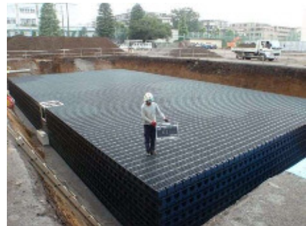
▲雨水貯留浸透施設
