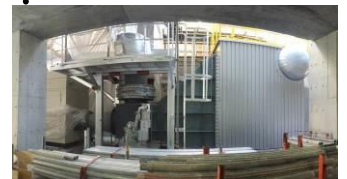
ガスコージェネレーション設備
