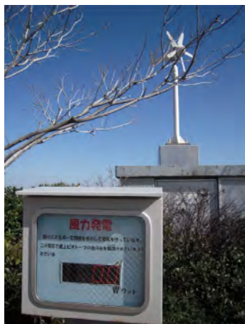
・風力発電(屋上)
