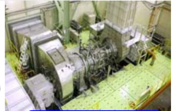
ガス・コージェネレーション設備外観
