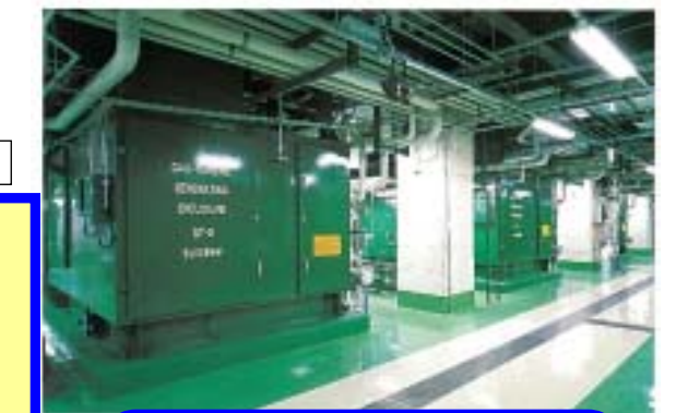
(事例)六本木ヒルズ ガス・コージェネレーション設備外観
