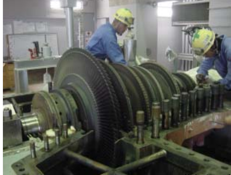
蒸気タービン
