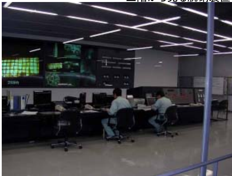
ガラス張りの中央監視室
