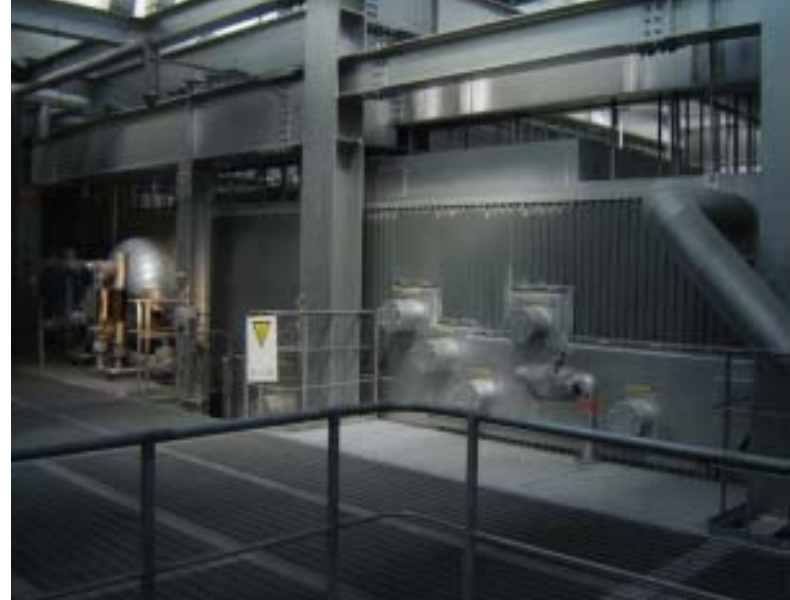
ボイラー(外観)
