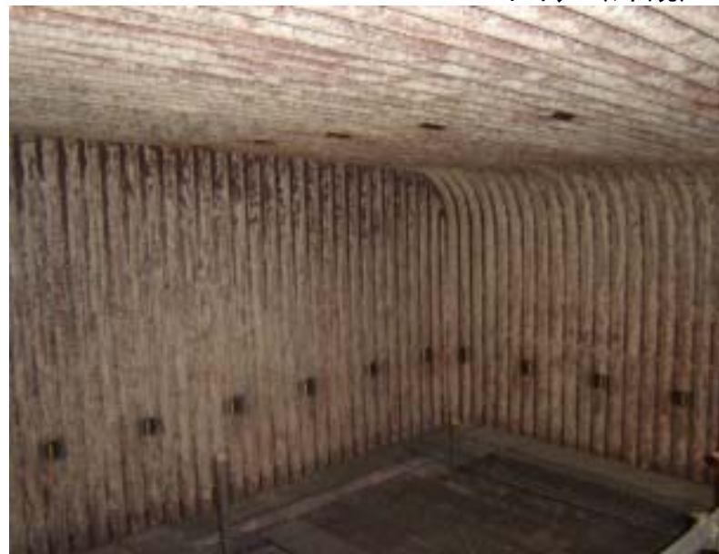
ボイラー(内部)
