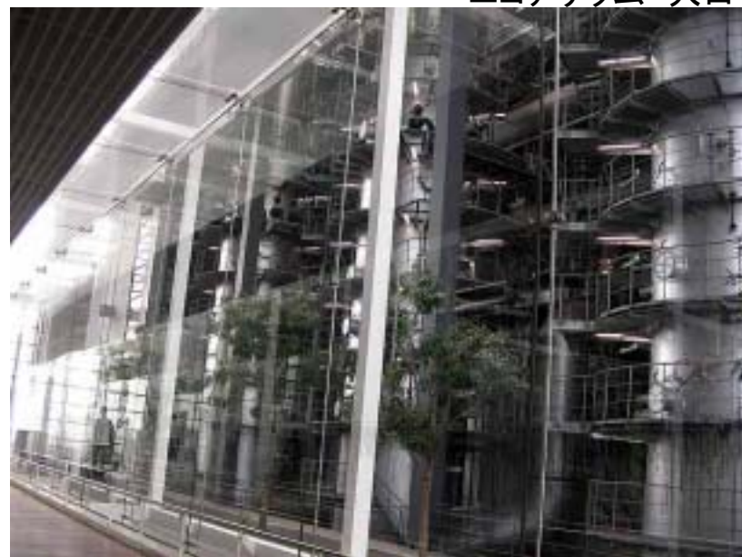
エコアリウムから見た脱硝装置
