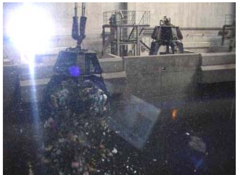
ごみクレーン
