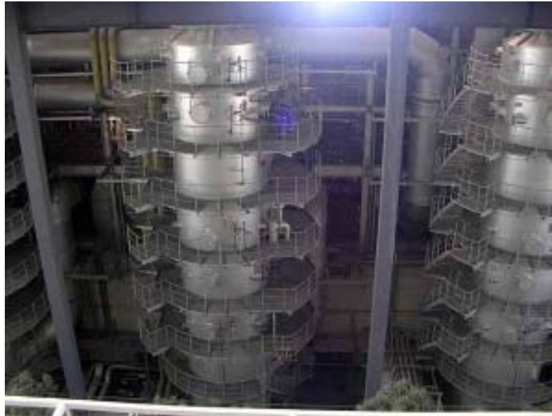
上階から見る脱硝装置
