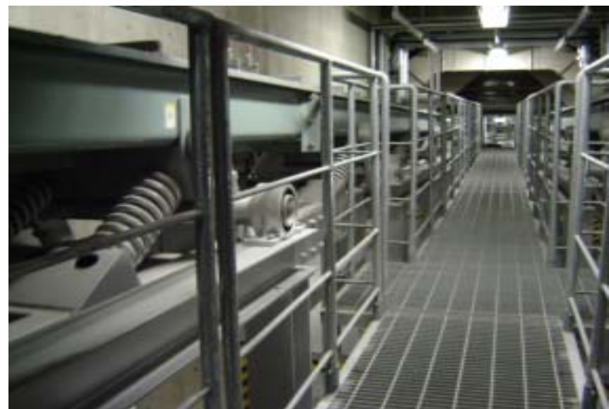
灰搬送コンベア
