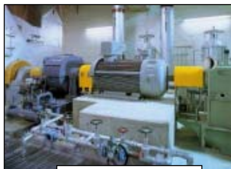
誘引送風機誘導発電機
