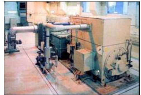
蒸気タービン発電機
