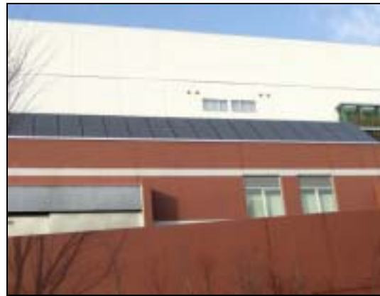
太陽光パネル。6年間の稼働で補修は一度も必要になっていない
