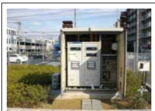
排ガス状況表示盤
