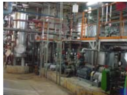
排水処理設備
