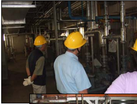
排水処理施設
