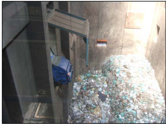
ごみピット内部の様子
