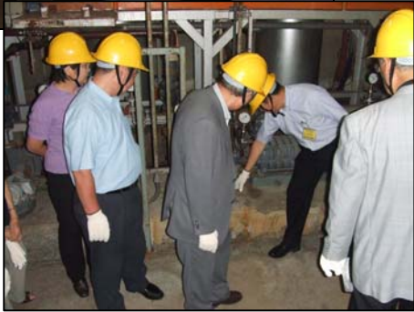
酸によってコンクリートの床が腐食されています。
