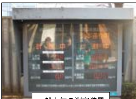
一般大気の測定装置
