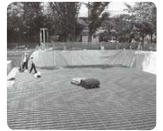
第三小 雨水貯留浸透施設
