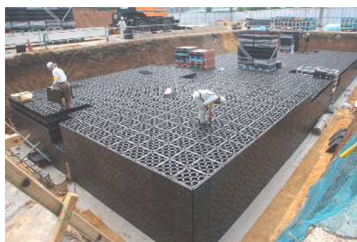
▲雨水貯留浸透施設
