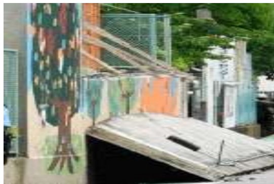
大阪府北部地震で倒壊したブロック塀（出典：内閣府）
