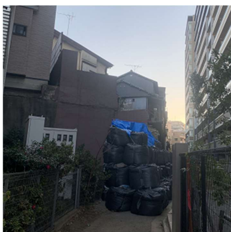
杉並区の擁壁倒壊事故（応急措置後）
