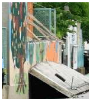
図 5-3 大阪府北部地震で倒壊したブロック塀 (出典：内閣府)
