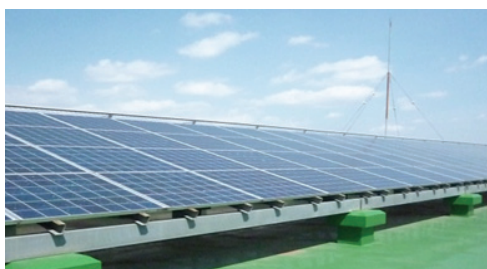
■太陽光発電パネル(関前南小学校屋上・30kW)
