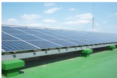
■太陽光発電パネル（関前南小学校屋上・30kW）
