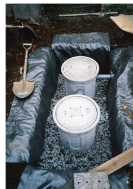
雨水浸透ます
