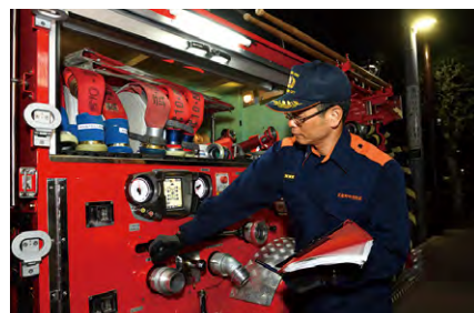
水量や圧力など、揚水状態が液晶画面に表示される消火ポンプ操作盤
