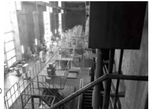
ポンプ室。センターで受け入れた下水をポンプアップする。森ヶ崎水再生センターは海岸近くであり、高潮被害防止のため周辺より高く作ってある
