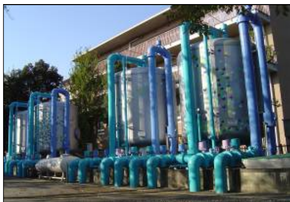
図3 除鉄・除マンガンろ過装置
