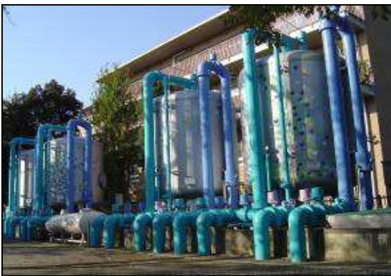
図3 除鉄・除マンガンろ過装置
