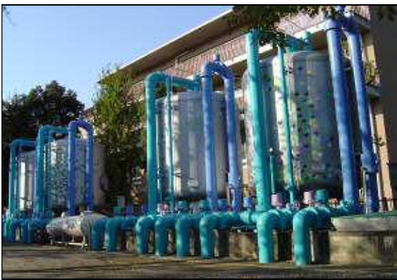
図3 除マンガン除鉄ろ過装置
