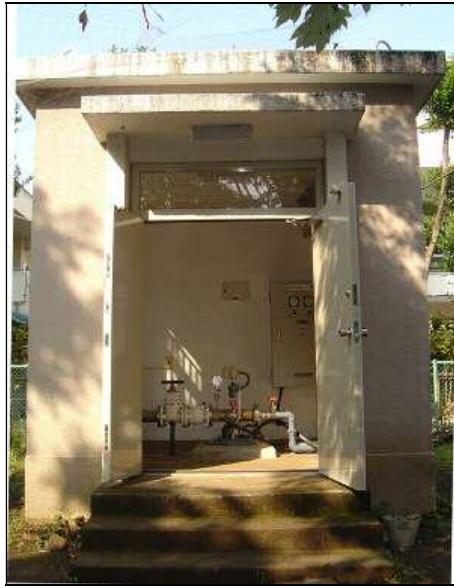
図1 深井戸水源の外観
