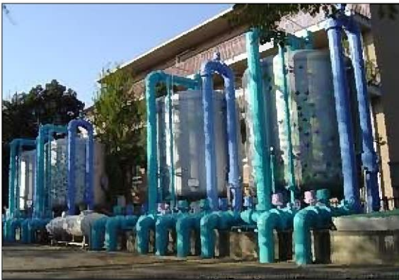
図3 除マンガン除鉄ろ過装置
