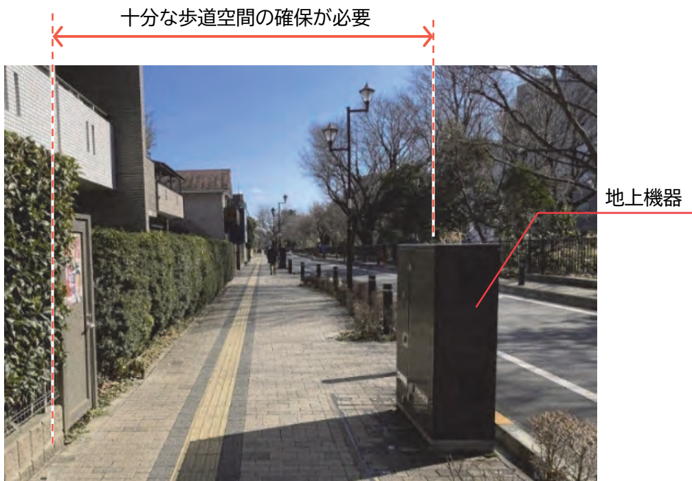
図3-10 歩道上に設置される地上機器（御殿山通り）
