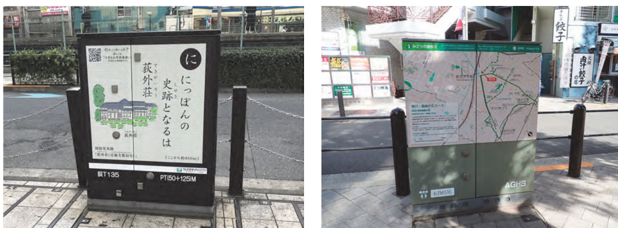
図4-3 地上機器の活用事例（杉並区荻窪・目黒区中根）
