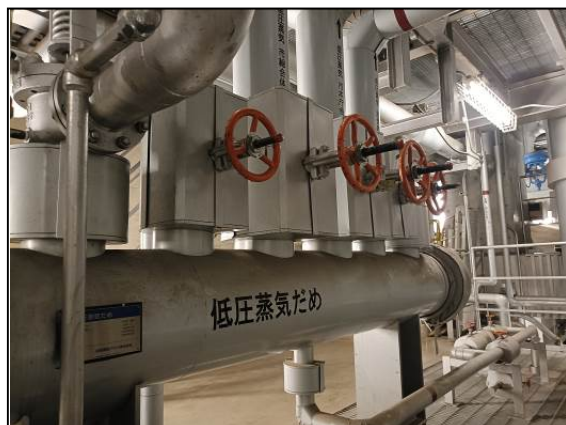
近隣施設への蒸気供給
