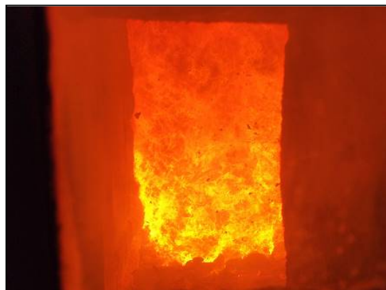
焼却炉内の様子
