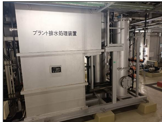
排水処理施設
