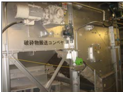
破碎物搬送コンベヤ
