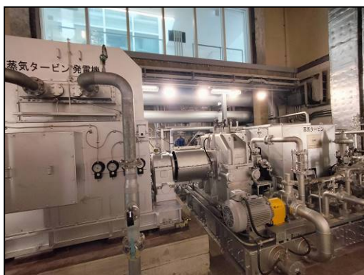
蒸気タービン発電機
