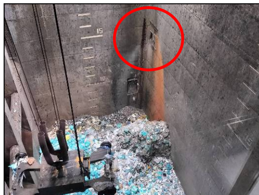
可燃ごみピットの落ち口
