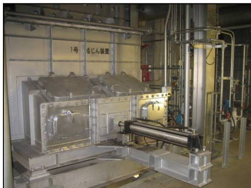
焼却炉へごみを送る給じん装置
