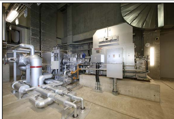
蒸気タービン発電機
