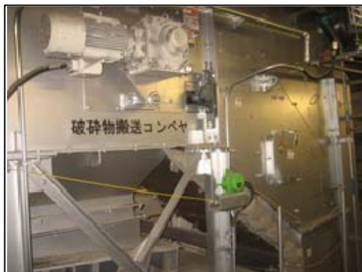
破碎物搬送コンベヤ
