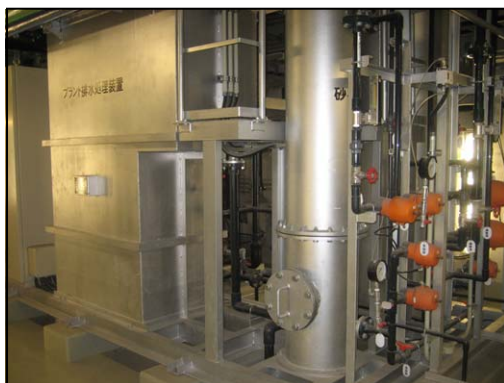
排水処理施設
