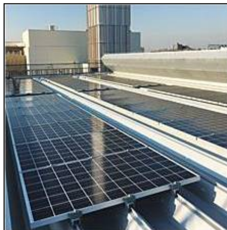
屋上の太陽光パネル（10 kW）
