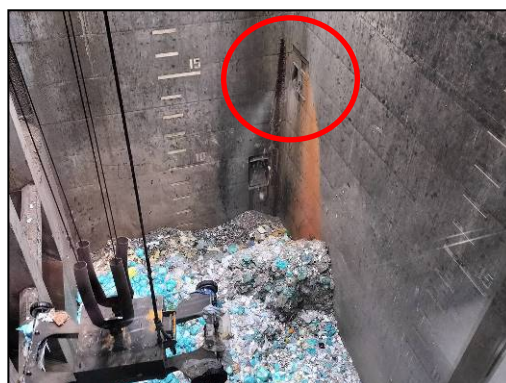
可燃ごみピットの落ち口
