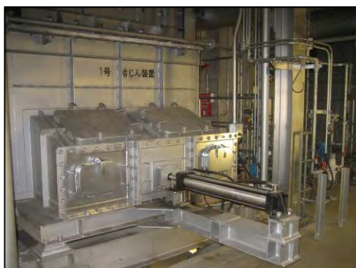
焼却炉へごみを送る給じん装置
