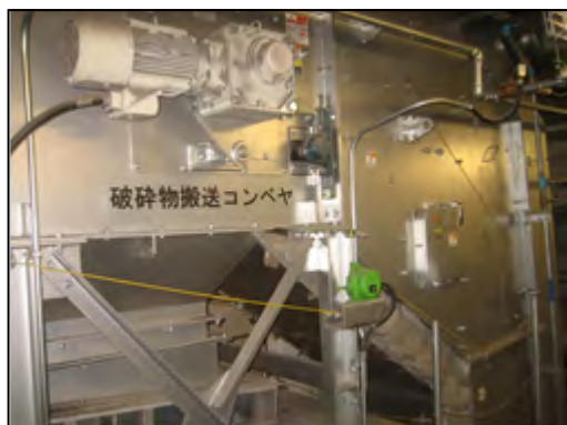
破碎物搬送コンベヤ
