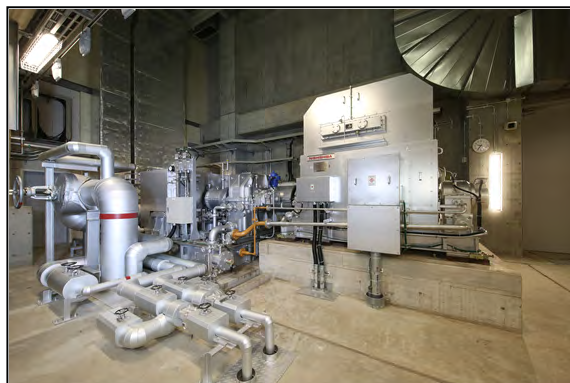
蒸気タービン発電機
