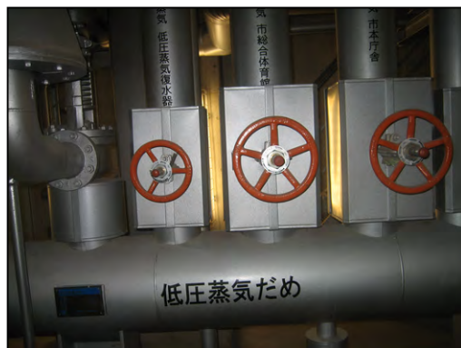
近隣施設への蒸気供給
