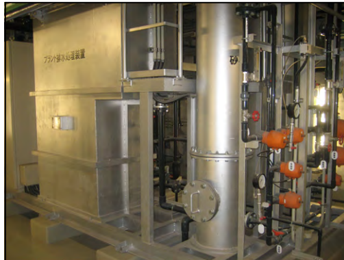
排水処理施設
