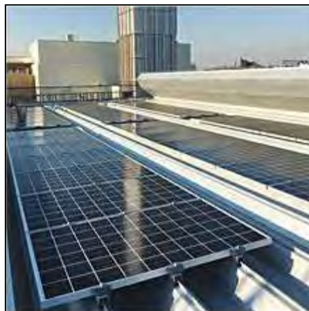
屋上の太陽光パネル（10kw）
