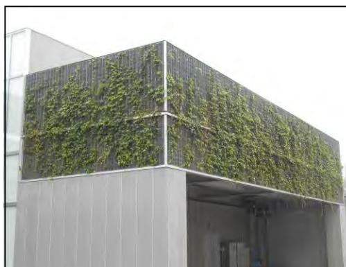
管理棟の壁面緑化
