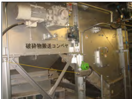
破碎物搬送コンベヤ
