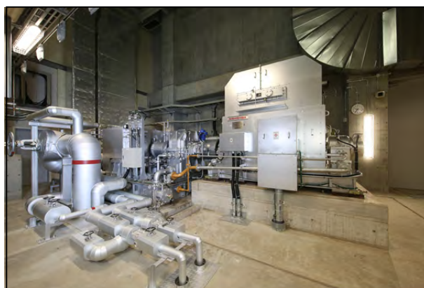
蒸気タービン発電機
