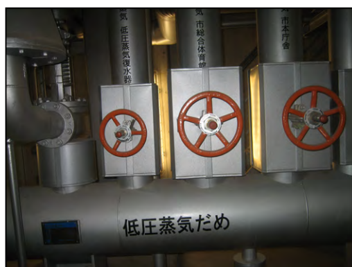
近隣施設への蒸気供給
