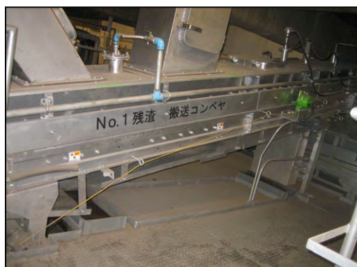
可燃ごみピットへ運ばれるコンベヤ
