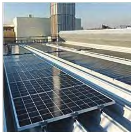
屋上の太陽光パネル（10kw）
