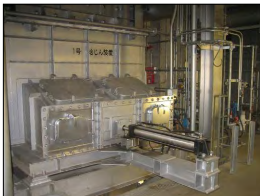
焼却炉へごみを送る給じん装置
