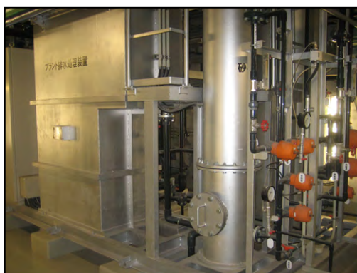
排水処理施設
