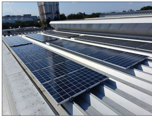
屋上の太陽光パネル（10 kW）
