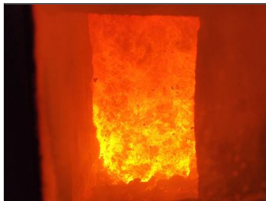
焼却炉内の様子
