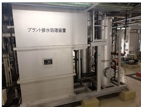
排水処理施設
