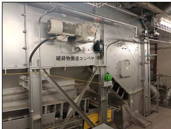
破碎物搬送コンベヤ
