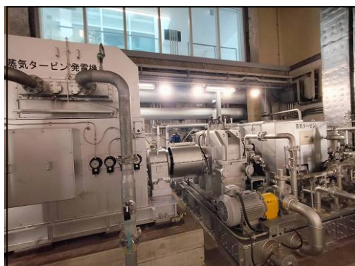
蒸気タービン発電機
